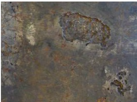
...fortgeschrittene Biokorrosion; ausgelöst durch mikrobielle Stoffwechsellätigkeiten.
