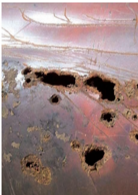
...Lochfraß, ausgelöst durch mikrobielle Stoffwechsellätigkeiten
