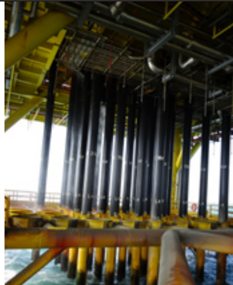
Tubos de salida (negro) después de 10 meses de operación
