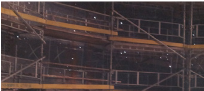
Antes de la restauración: Perforaciones por corrosión claramente visibles. La empresa ISDW sella los agujeros y aplica un laminado con fibra de vidrio en los puntos dañados.
