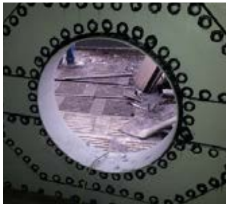
Extra, sellado flexible de los rivetes, soldaduras y resaltes.
